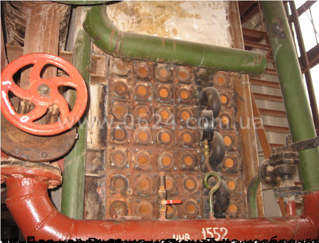
Оборудование в котельной на территории предприятия в поселке городского типа ЧАТ. На 6 км
